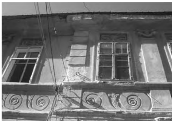
Școala Maghiară, clădire monument istoric. Intervențiile făcute de proprietar (RMGC) au distrus profilurile exterioare (Foto: Luminița Dejeu)
