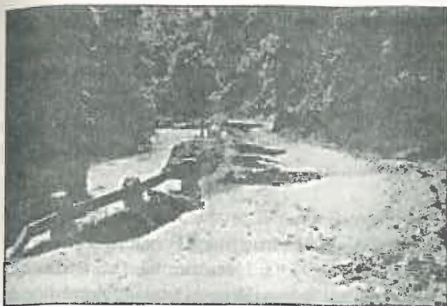
Fig. 1. Autrenarea umpluturii din spatele zidului, ca urmare a distrugerii fundației la nivelul rostului de legătură. Drum forestier Olănești-Mînză. (Drawing of paddings behind the wall as a result of destroying the foundation. Forest road Olănești-Mînză). Foto: Ivănuș Puiu - 1975.
