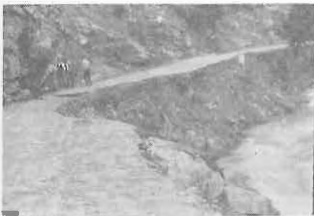
Fig. 3. Pagube cauzate drumului forestier de către inundația din anul 1969.
