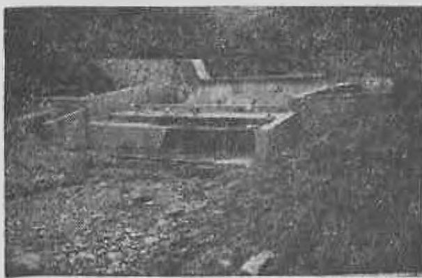
Fig. 5. Radier secund executat în trepte la barajul 2 M_{2,0} de pe ravena Rușețu — perimetrul Moroieni
