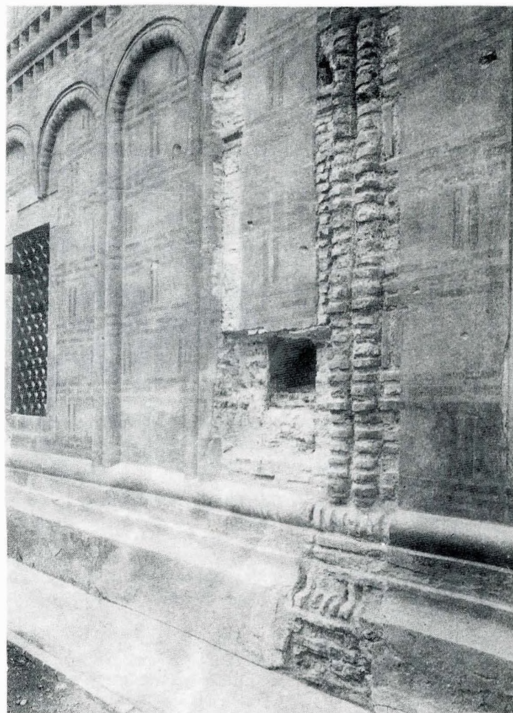
Fig. 2 Biserica Mihai Vodă din București. Sondaj pe fațada de sud, cu apariția unei ferestre a pronaosului, înzidită ulterior. Foto W. Weiss, 1932, cliseu C.M.I., fototeca D.M.I.
