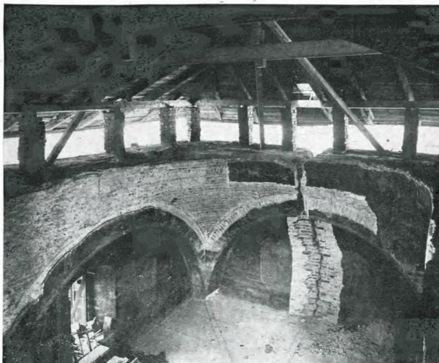
Fig. 29. — Vederea urmelor dela calota sferică a pronaosului, precum și a crăpăturii din fațada de Apus. Acoperișul este ridicat cu 0,80 m.
