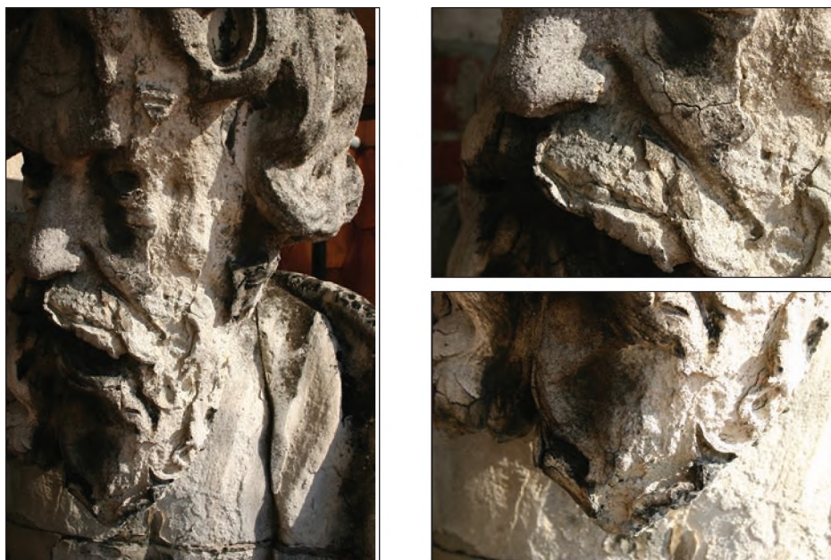
Fig. 14 - Degradare complexă: dizolvare, dezagregare, termofisurare, crustificare și biodegradare. / Complex degradation: dissolution, disintegration, thermal fracturing, crusting and biodegradation.
