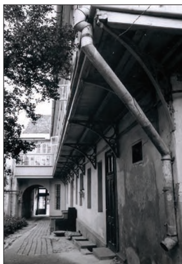
Fig. 28 Galerie la casa de pe str. 1 Decembrie, Nr. 1 / Maison – 1, Rue 1 er Décembre; détail de la coursive
