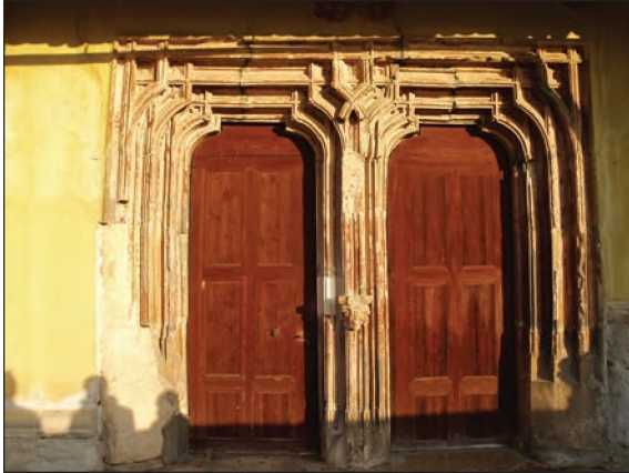
Fig. 7 - Biertan. Portalul de vest al bisericii evanghelice fortificate (c. 1500). Deteriorări și intervenții nocive / Biertan. West portal (about 1500) - deteriorations and harmful interventions
