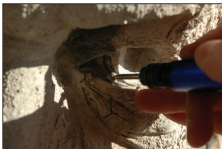
Fig. 17 - Îndepărtarea manuală a crustelor minerale consistente cu ajutorul frezelor stomatologice, fațada Lipscani / Manual removal of the consistent mineral crusts using stomatologic drills, the Lipscani facade.
