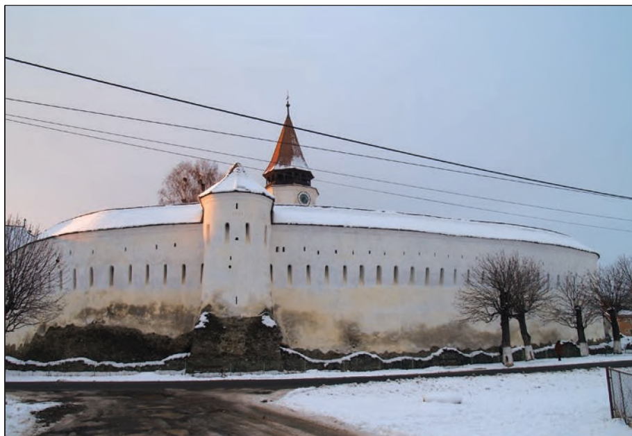
Fig. 5 - Prejmer. Perspectivă asupra bisericii fortificate dinspre sud-est; umiditate excesivă în ziduri / Prejmer. South- East perspective to the fortified church; humidity in excess into the walls
