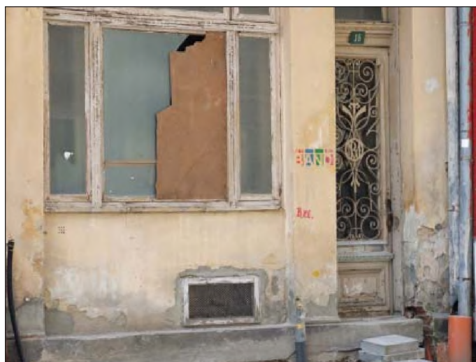
Fig. 14 - Obturarea voluntară a deschiderilor clădirii duce la lipsirea acesteia de ventilația neapărat necesară sănătății sale
