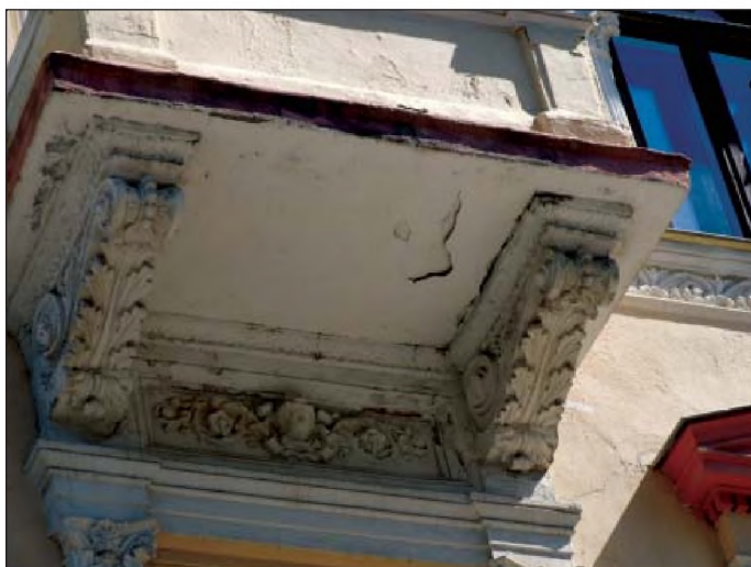
Fig. 11 - datorită materialelor și tehnologiilor neadecvate
