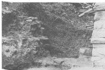
17. Caseta C VI – vedere asupra dublării cu cărămidă a zidului corpului de casă de N
