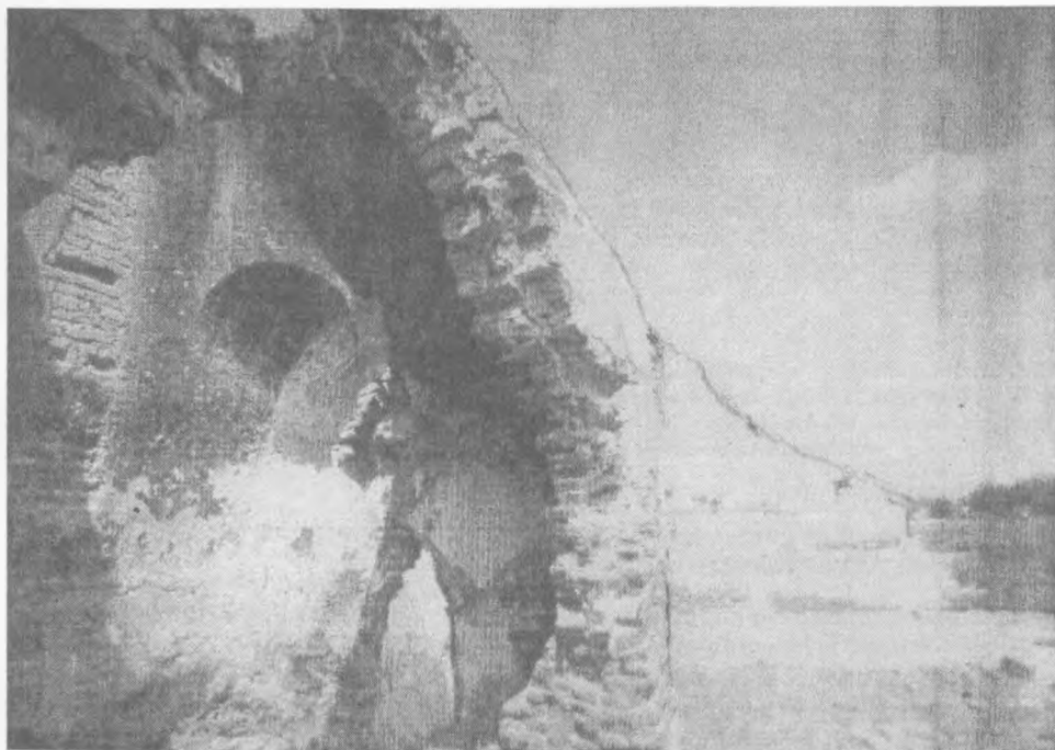
Ruina bucătăriei (trompa de colț)
