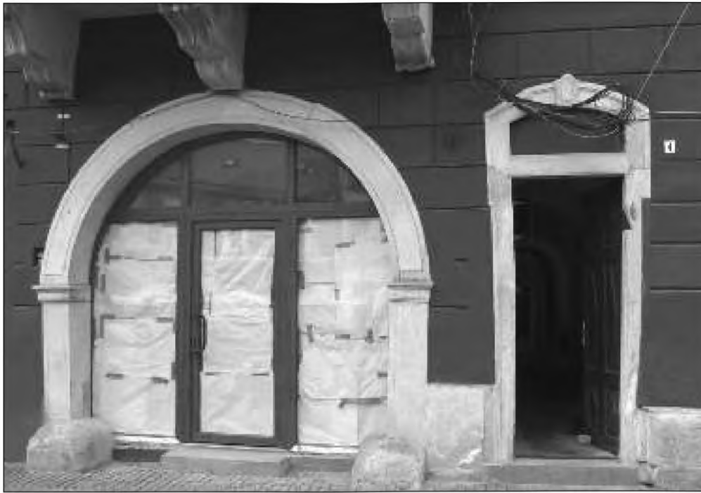
• Porți cu ancadrame în stil baroc, una pentru pietoni, cealaltă pentru căruțe, ale casei clujene din bulevardul Eroilor, nr. 4. Foto: Lukács József
