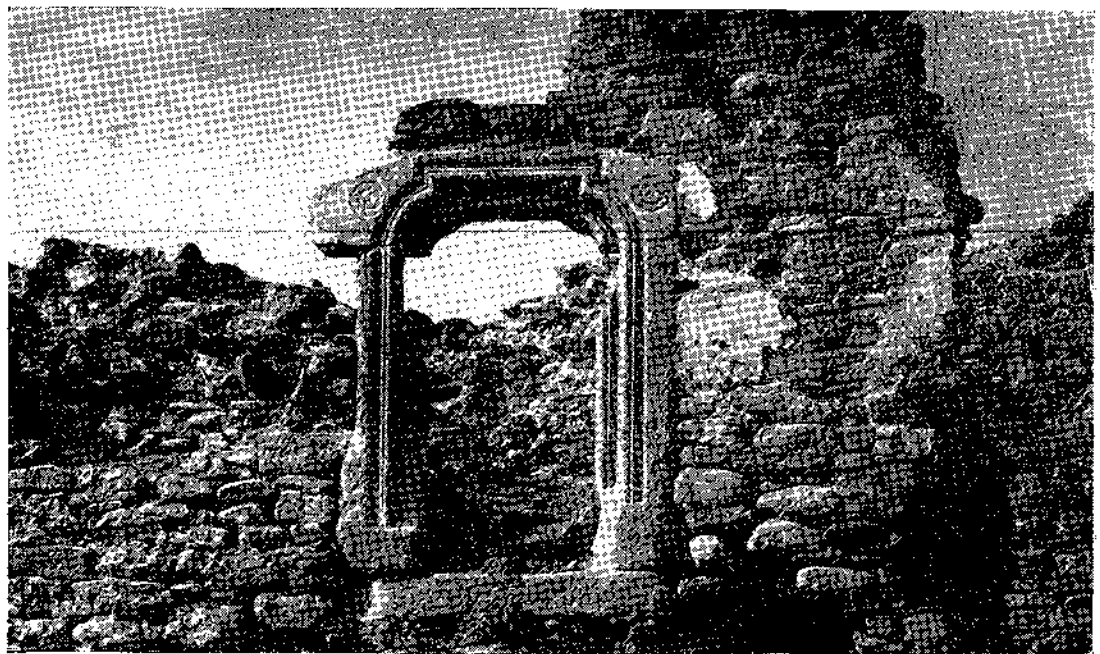
Fig. 59. Clisiarnița. Ușa exterioră de la etaj, înainte de restaurare
